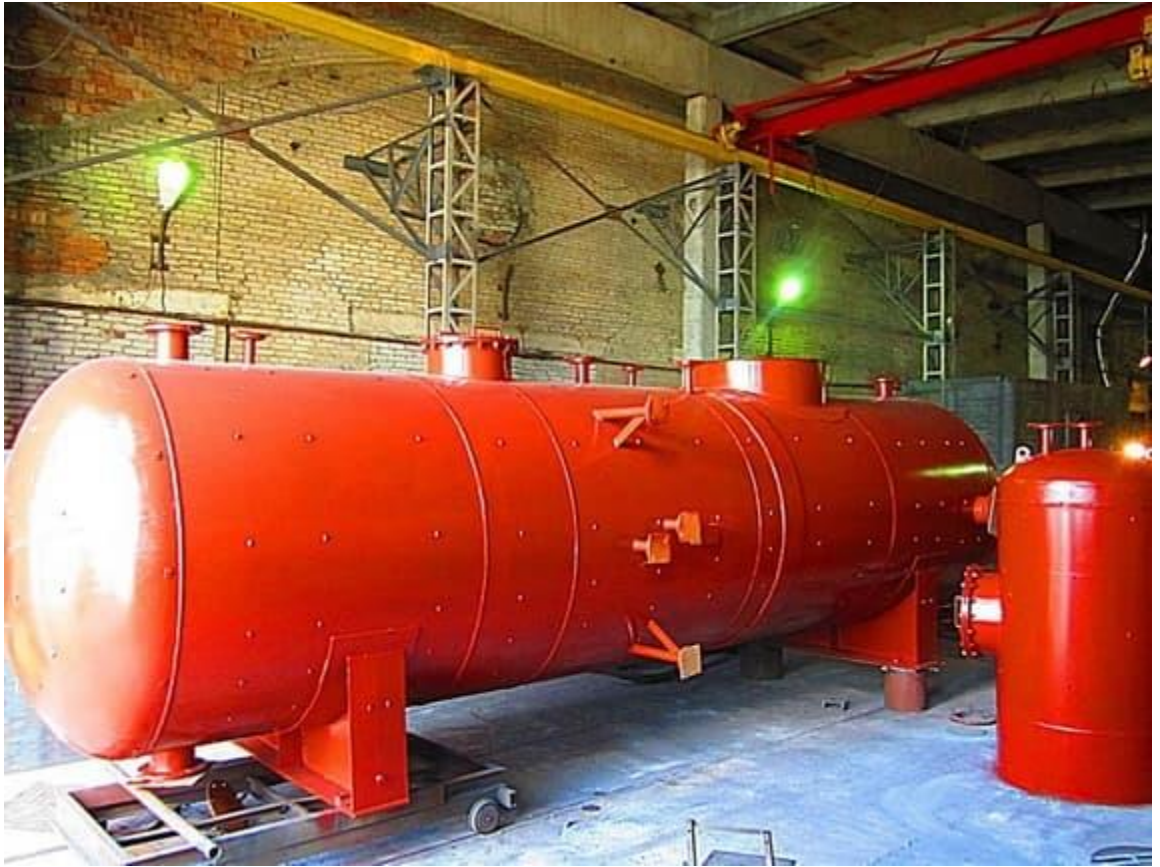
Рисунок 2.3 – Загальний вигляд деаератору
