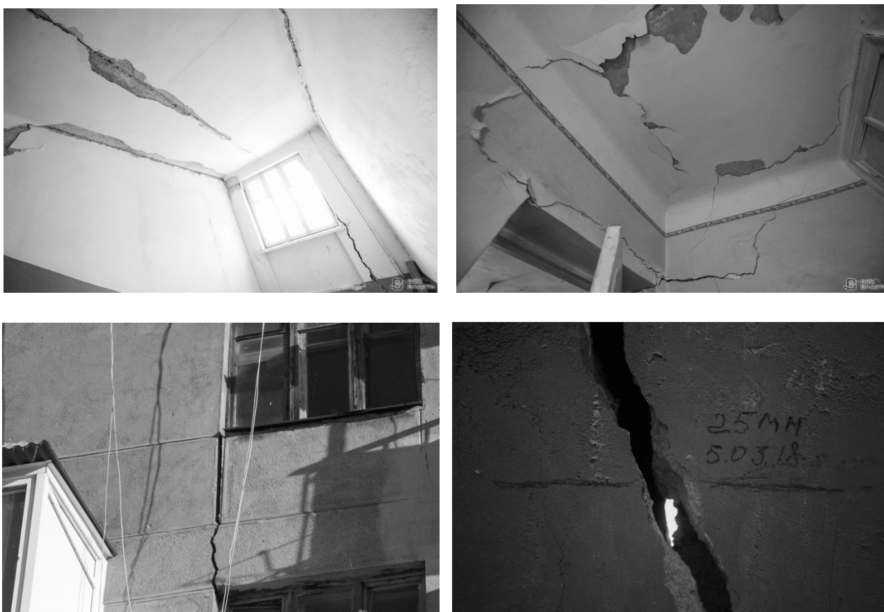
Рис. 3. Деформації житлового будинку в м. Запоріжжя на б. Шевченка, 42
