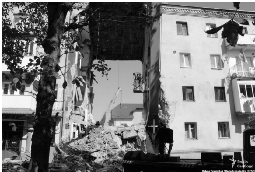
Рис. 4. Обрушення частини житлового будинку в м. Дрогобич (2019)
