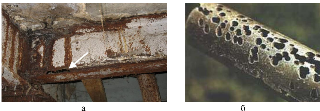
а – наскрізна корозія стінки балки; б – піттингова корозія Рис. 1. Корозійне руйнування металоконструкції
