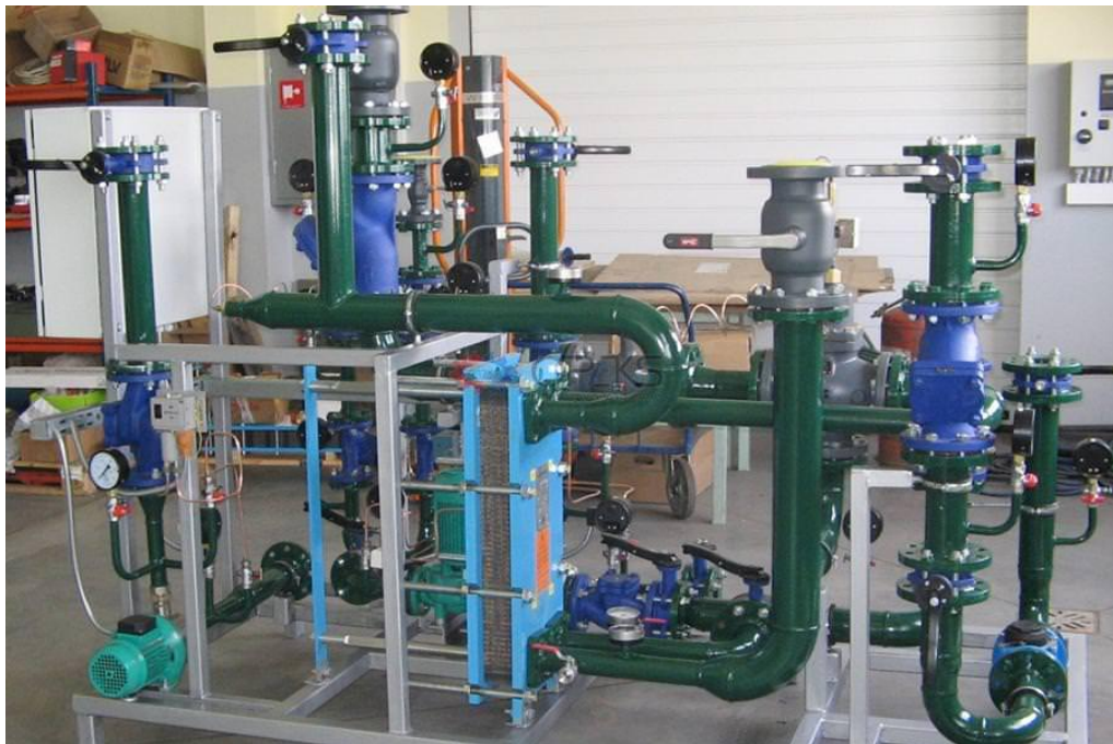
Рисунок 2.4 – Індивідуальний тепловий пункт
