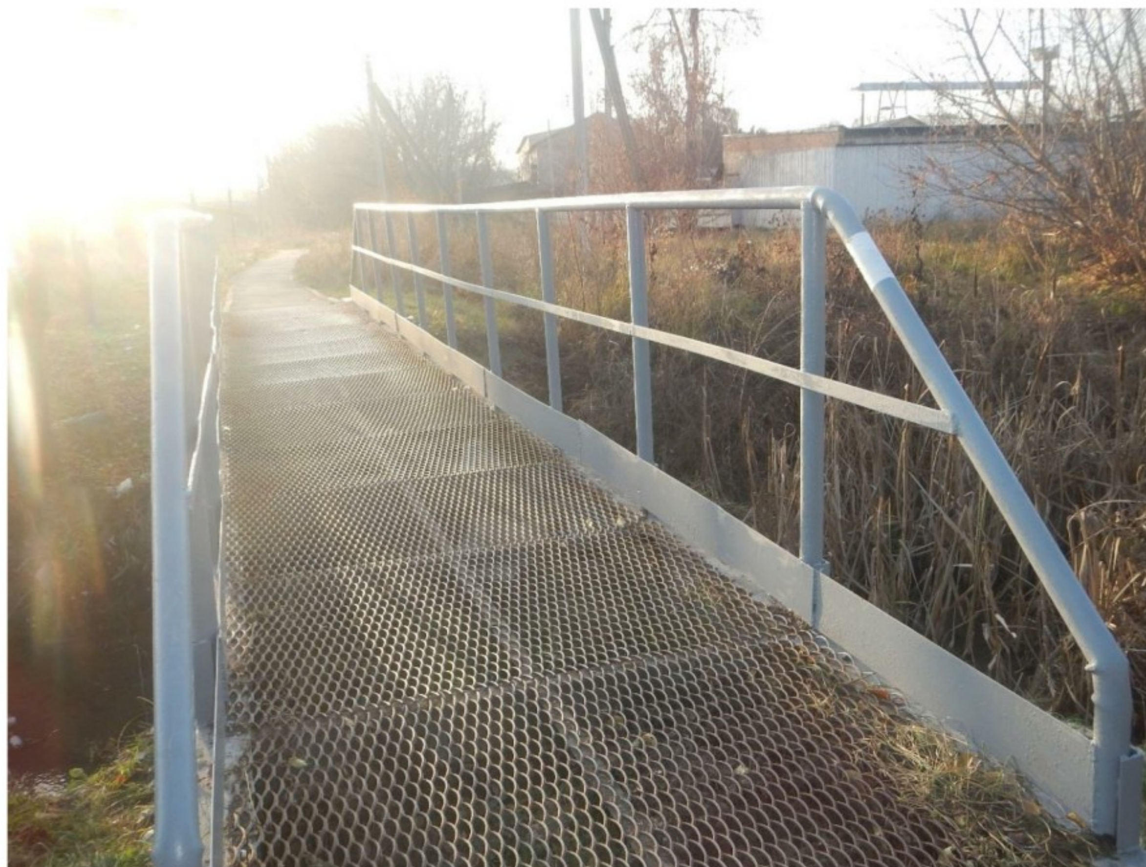
Рисунок 3.6 Деформація, недостатня жорсткість листа покриття мосту
