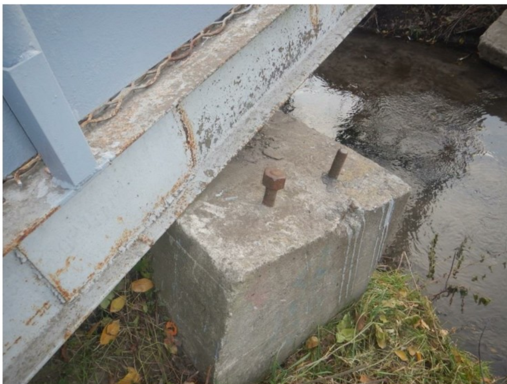
Рисунок 3.9 Корозія поверхні металевих конструкцій мосту
