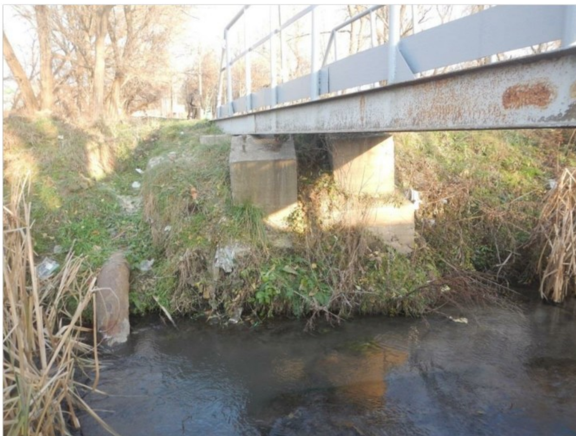
Рисунок 3.11 Розмив та зсув фундаментних блоків при підвищенні рівня річної води.
