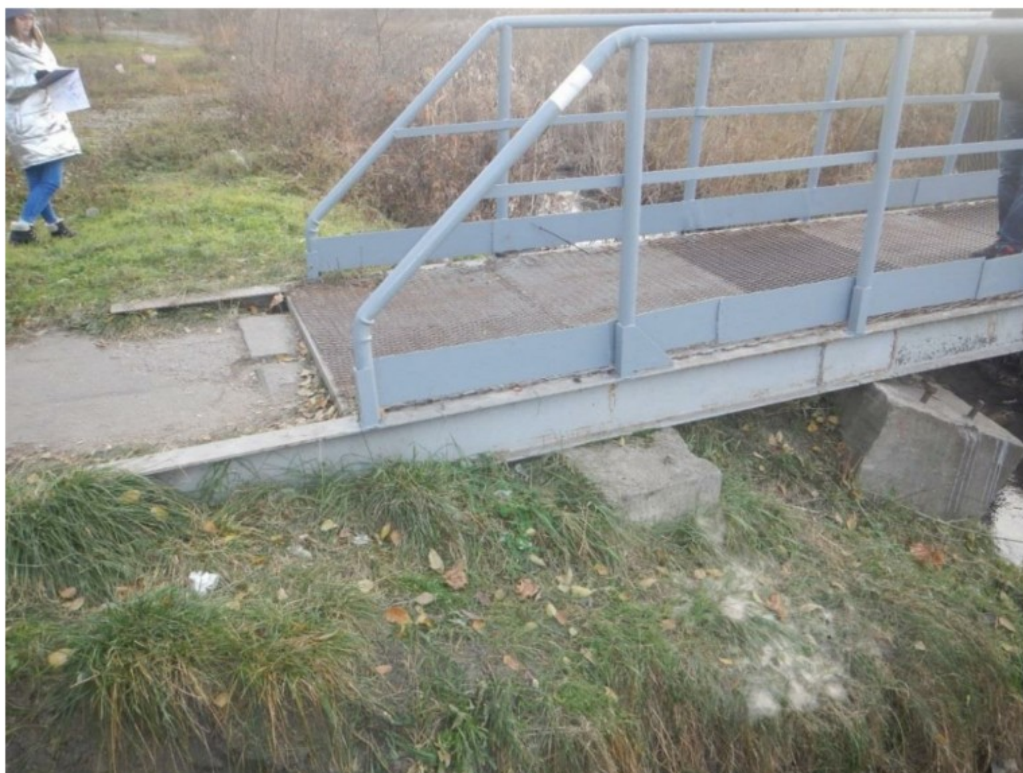
Рисунок 3.12 Розмиття ґрунту підходів до мосту за відсутністю організованого водовідведення та належного покриття підходів до мосту.
