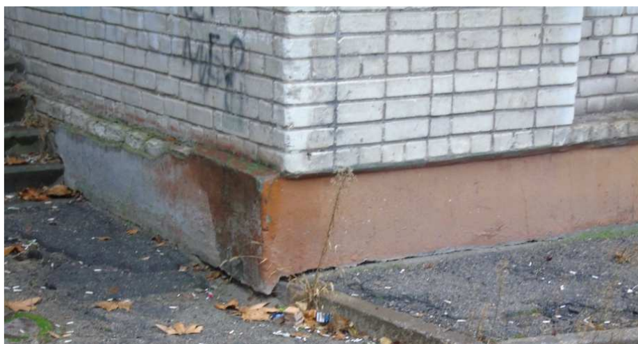
Рисунок 3.21 – Тріщина в місці примикання вимощення до цоколю
