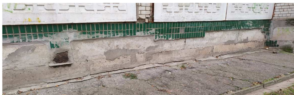
Рисунок 3.16 – Тріщина в місці примикання вимощення до цоколю, відшарування оздоблення цоколю
