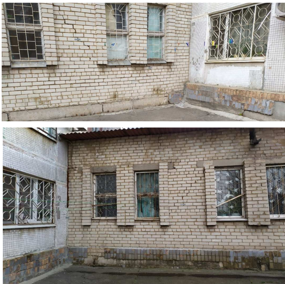
Рисунок 3.14 – Розкриття тріщин через нерівномірний осад
