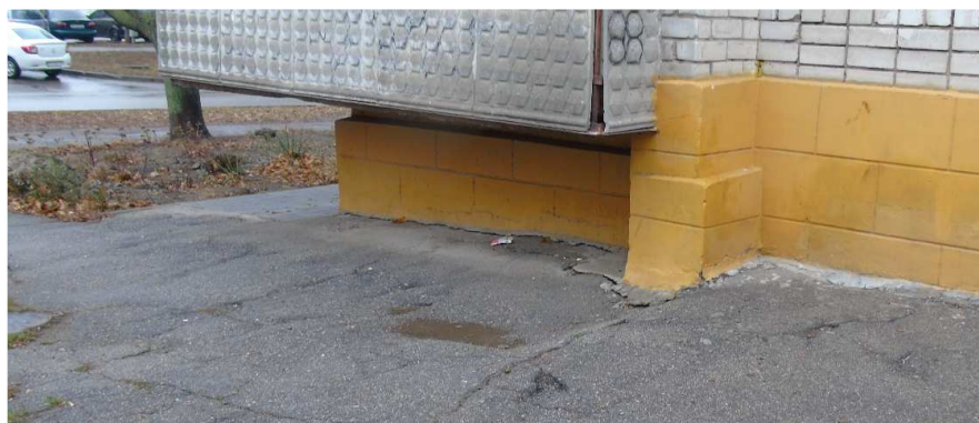
Рисунок 3.23 – Тріщина в місці примикання вимощення до цоколю
