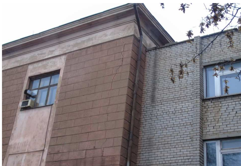
Рисунок 3.27 – розкриття тріщин головного корпусу
