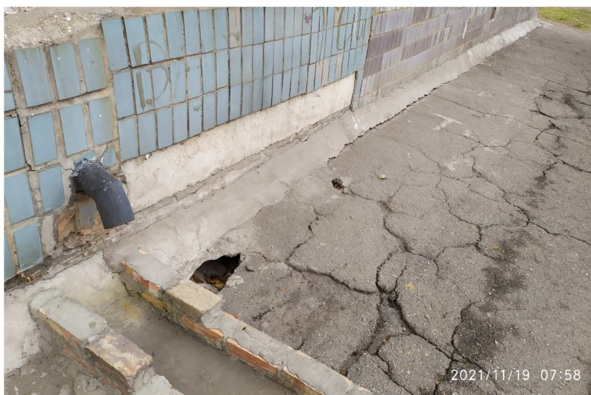
Рисунок 3.11 – Руйнація старого вимощення та тріщина в місці примикання до цоколю
