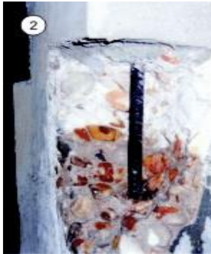
Рисунок 3.7 - Оголена (відкрита) арматура
