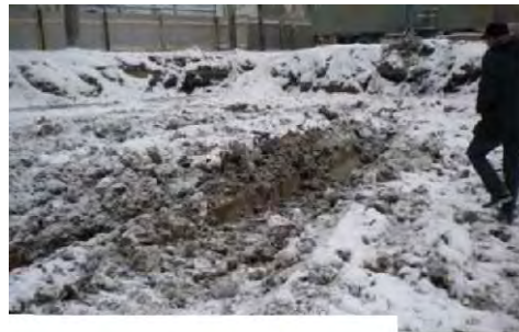
Рисунок 3.9 – Наслідки механічного пошкодження основи
