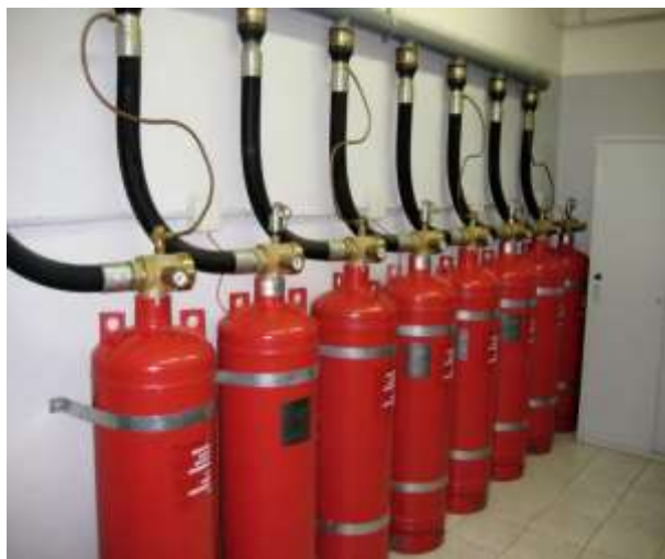
Установка газового пожежогасіння
