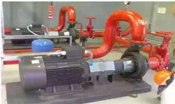
Установка водяного пожежогасіння
