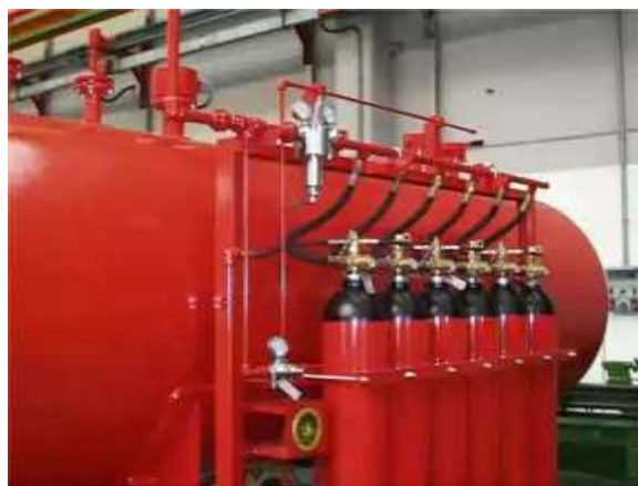
Установка порошкового пожежогасіння
