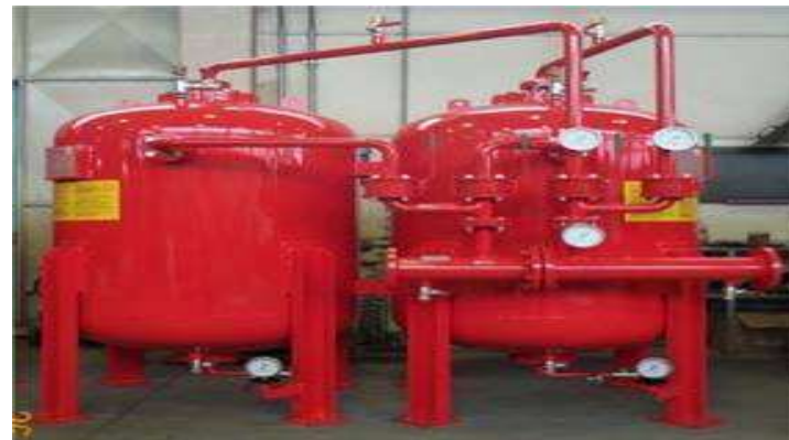
Установка пінного пожежогасіння
