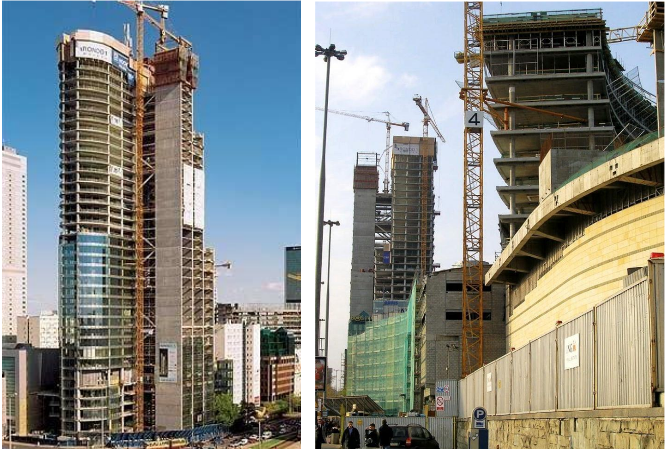
Рисунок 1.6 – Зведення каркасу будівлі “RONDO” № 1 за допомогою приставних баштових кранів (м. Варшава, Польща)
