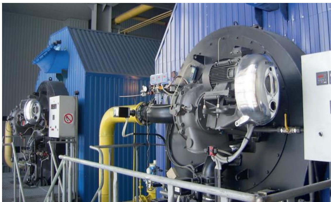
Рисунок 2.2 - Загальний вигляд котельної (котел КВ-ГМ-20-150)
