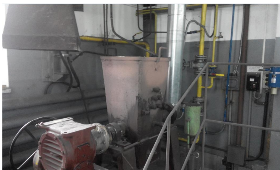
Рис.5.32. Опытная установка аглоцефа для спекания агломерата
