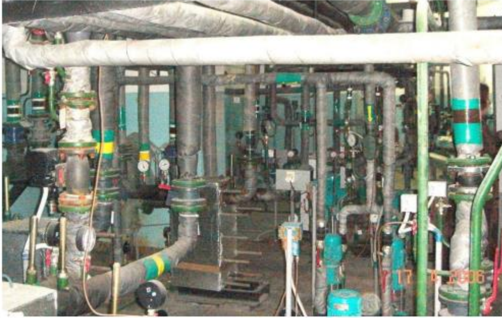
Рисунок 2.3 – Сучасний тепловий пункт з автоматизованими модулями
